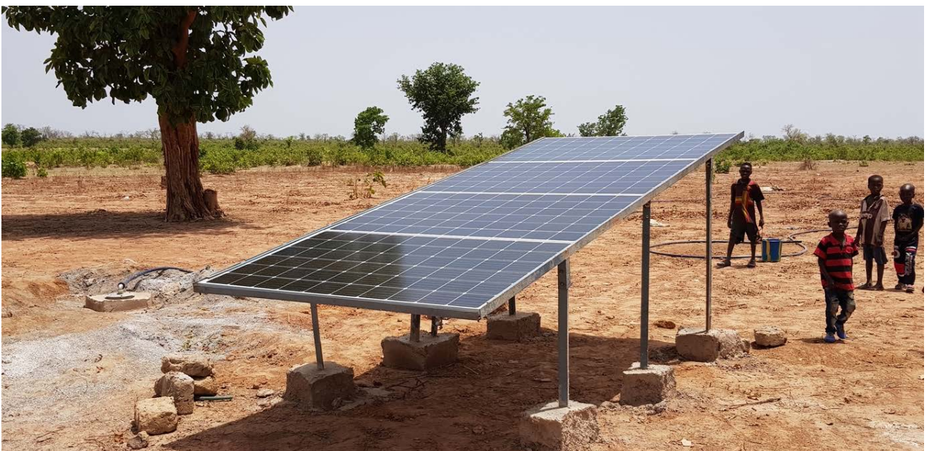
© Ulrike Däßler: die Solaranlage für den Brunnen
